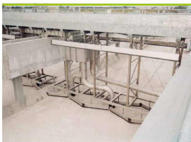
vue du raclage de fond avec la reprise des boues par les tubes suceurs et la boîte à boues – station d'épuration de Milan (Italie)
